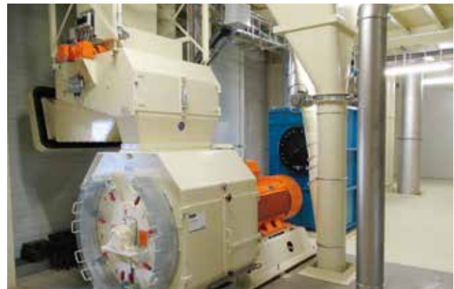
Hammermühle 250 kW mit Filteranlage Hammer mill 250 kW with filter system
