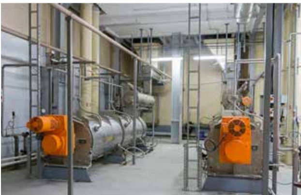
Konditionierung und Hygienisierung 2 x 20 t/h Conditioning and hygienisation 2 x 20 t/h
