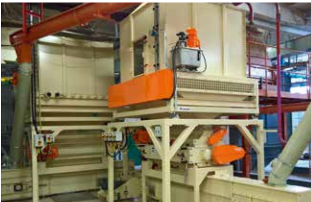
Kühler und Granulierung | Cooler and granulation
